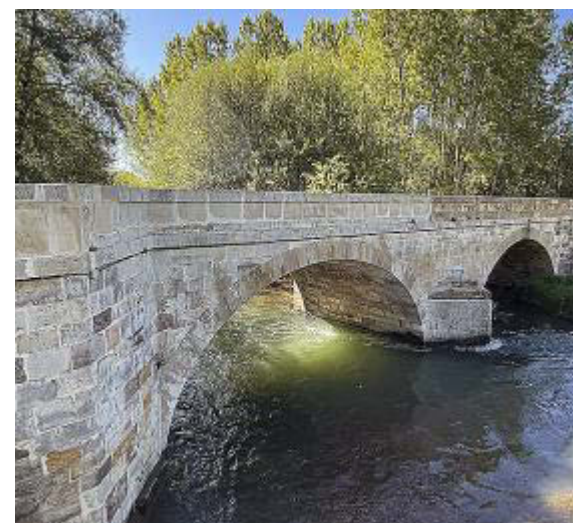
La caída del puente viejo conmocionó a los vecinos.
